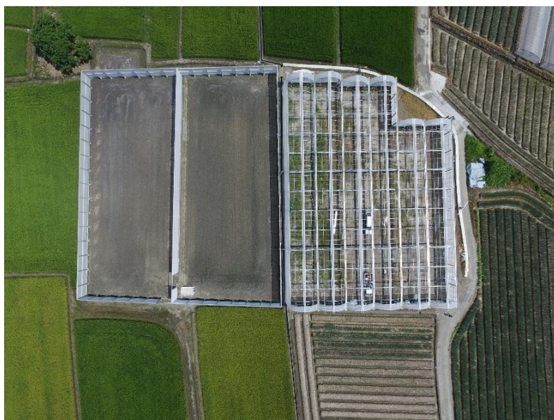
H 型鋼構防風網設施(左)及防颱網室(右)施工期間空拍圖
