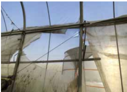
圖四、牆面紗網有破洞。
