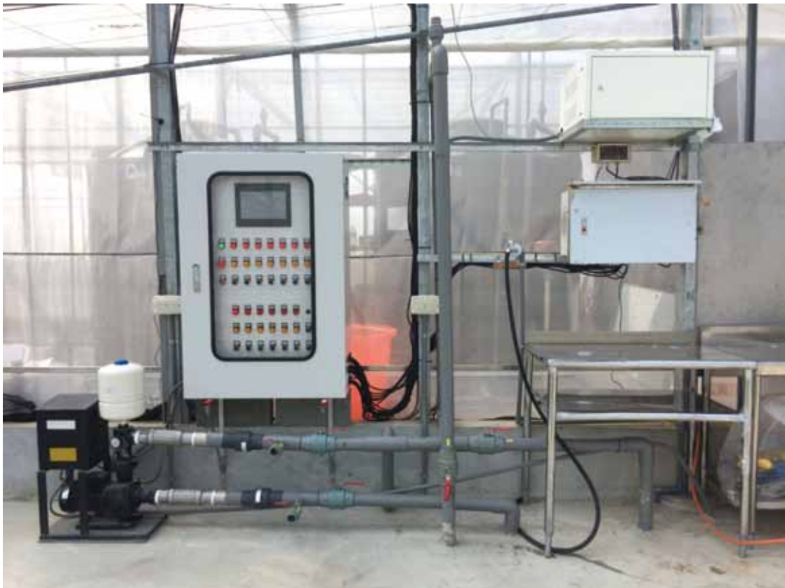
圖三、設施滴灌栽培供水馬達及配管現場配置圖。
