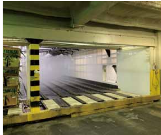
圖八、玉米水冷設備。
